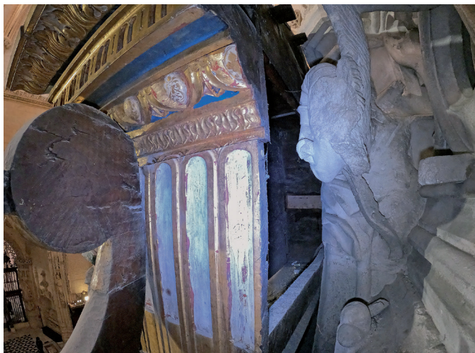
Fig. 26. Ángel portador de “arma Christi” en el remate conopial. Taller de Simón de Colonia. Presenta importantes daños posiblemente provocados al colocar el retablo renacentista
